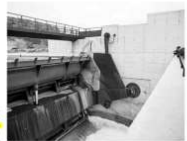
40 Prozent mehr. Das gestern eingeweihte Flusskraftwerk Hagneck produziert 40 Prozent mehr Strom als das bisherige ältere stützgelegte Werk. FOTO: G. SCHMIDT
